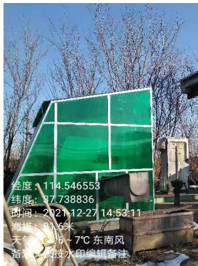
图 4-5 提升水泵及粗格栅
