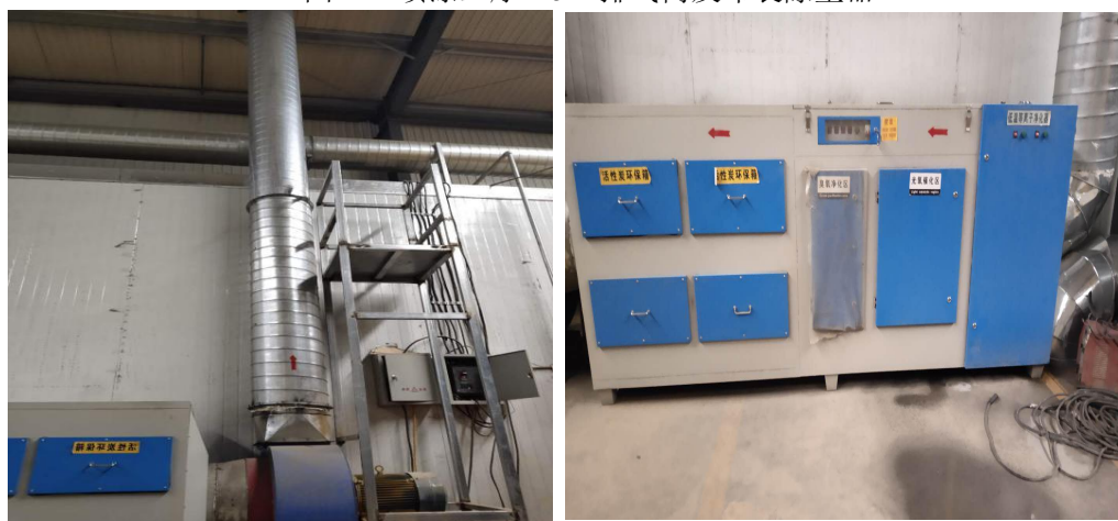
图 4-2 固化流平工序：15m 排气筒及处理设施
