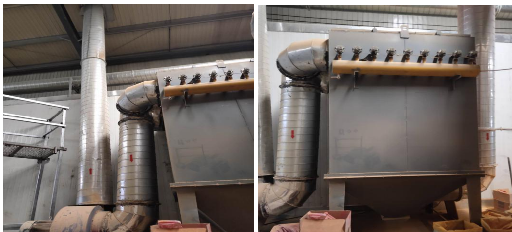
图 4-1 喷漆工序 15m 排气筒及布袋除尘器
